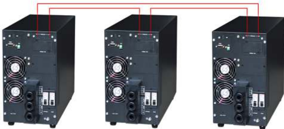
Figura: Sistema de 3 nobreaks em paralelo
